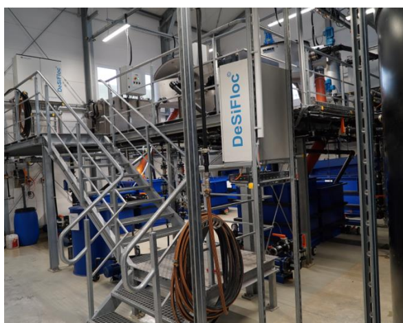
Abb. 14: Teilansicht der DeSiFloc Anlage
