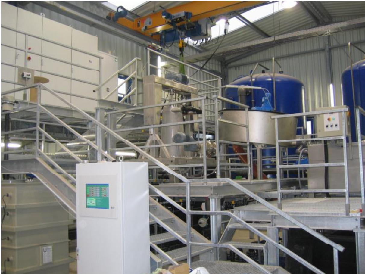
Abb. 11: Behandlungs- und Klärungsschritte des Deponiesickerwassers in der DeSiFloc Anlage
